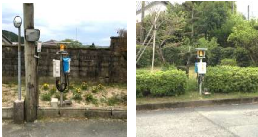
図 18. 疑似現場で設置された検査用装置
