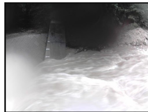
台風時に捉えた砂防ダムの写真（事例）
